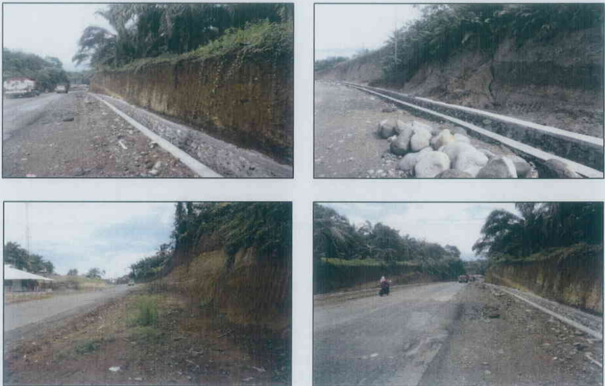
Gambar 3. Lokasi galian lereng tegak yang memerlukan pengadaan tanah tambahan pada Ruas Jalan Padang Sawah – Simpang Empat
